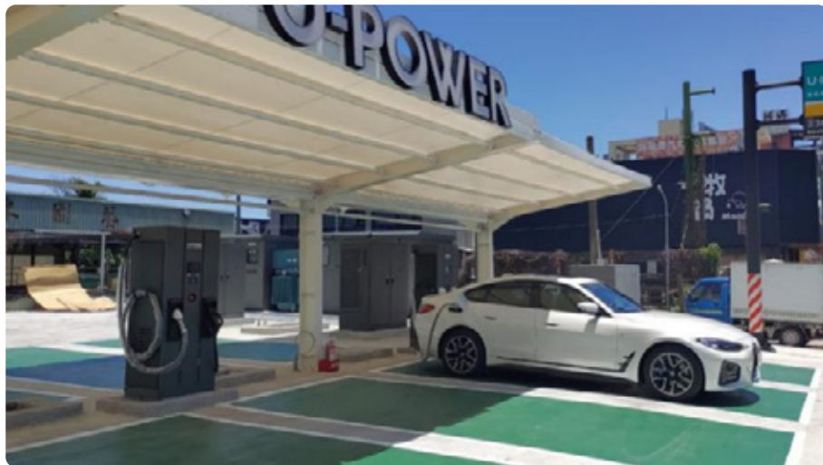
U-POWER 超高速充電站，採用全球最高功率 360kW 充電樁為單樁雙槍配置。
