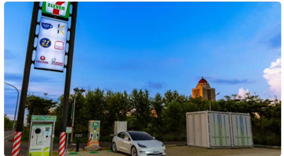
台泥儲能台南亞萬站使用飛宏 DC 快充樁，分別設置 1 座快充樁與 2 槍規格
